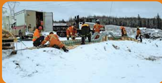
Assemblage d'isolateurs, pylône 320
