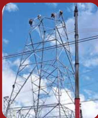
Pylône # 16, au centre du terrain de golf
