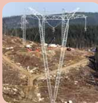
Pylône en V haubané, # 523, sur le chemin d'accès BA-16
